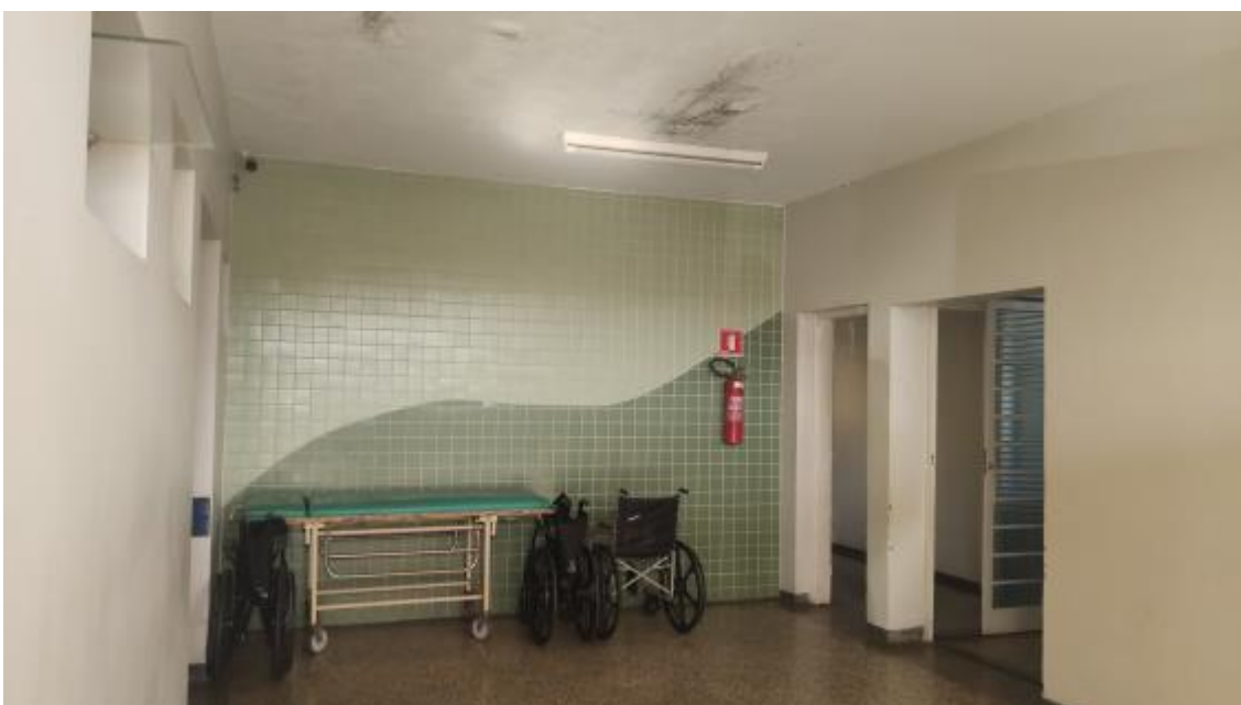
Pontos de bolor e fungo no teto;
